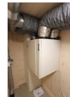
Ventilasjons anlegg montert i kjeller.
