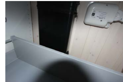
Kanal fra avtrekk.
