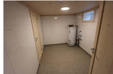
Vaskerom i kjeller.
