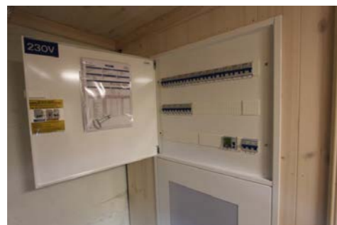
Sikringstavle med automatsikringer.
