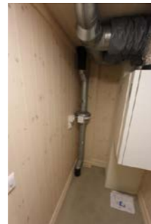
Radon brønn med avtrekk i kjeller.
