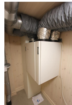
Ventilasjons anlegg montert i kjeller.
