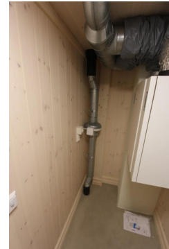
Radon brønn med avtrekk i kjeller.
