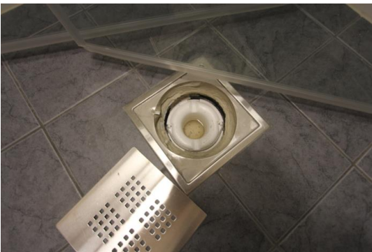
Sluk med slukmansjett.
