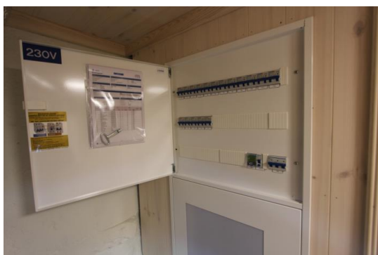
Sikringstavle med automatsikringer.
