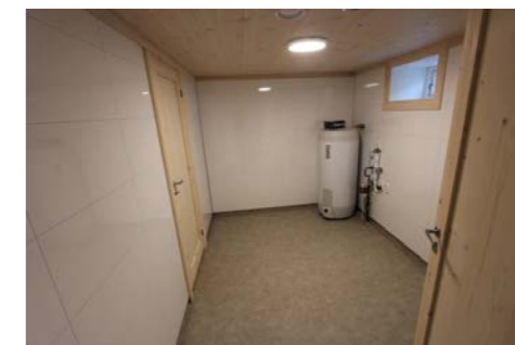
Vaskerom i kjeller.
