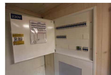
Sikringstavle med automatsikringer.
