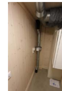
Radon brønn med avtrekk i kjeller.
