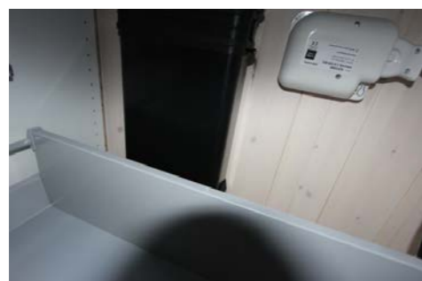
Kanal fra avtrekk.
