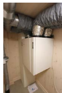
Ventilasjonsanlegg montert i kjeller.
