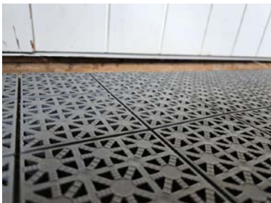
Åpning under terrassedør.
