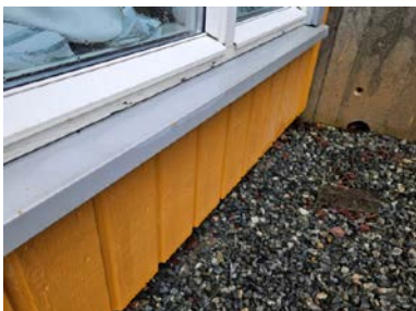
Eksempel på maling som flasser på utvendig karm.
