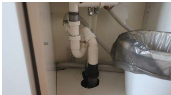
Benkeskap under oppvaskkum. Rør i rør.
