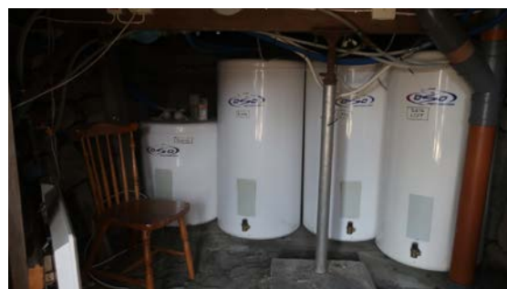
V.v.beredere i teknisk rom i kjeller.
