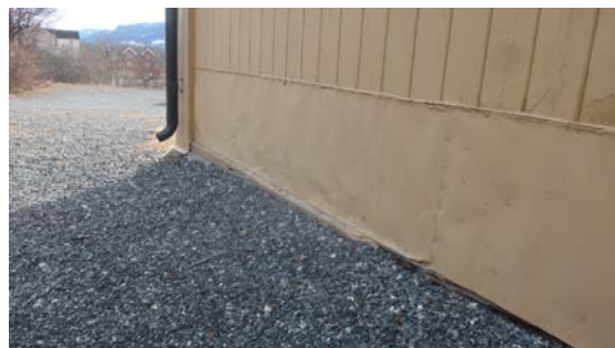
Rester av vannbrett.
