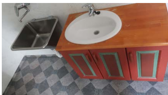
Stål skyllekum og baderomsinnredning med servant.
