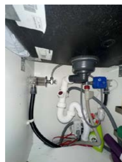
Røropplegg i kjøkkenbenk med Waterguard
