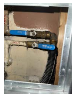
Vanntilførsel med eldre kobberør
