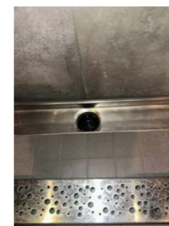
Slukrenne plassert i dusjnisje
