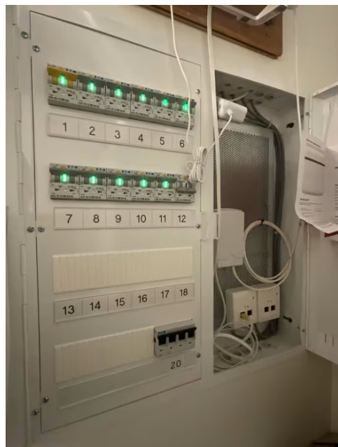
Viser sikringsskap med ekom del.
