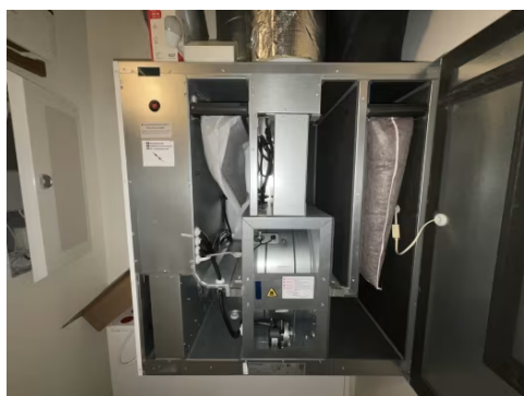
Viser ventilasjonsaggregat innvendig.
