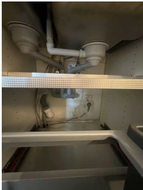
Viser vann og avløpsinnstallasjoner under kum.
