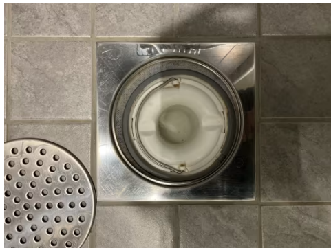
Viser sluk i dusjsonen.
