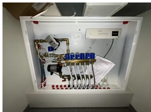
Viser gulvvarmeskap plassert i teknisk rom.
