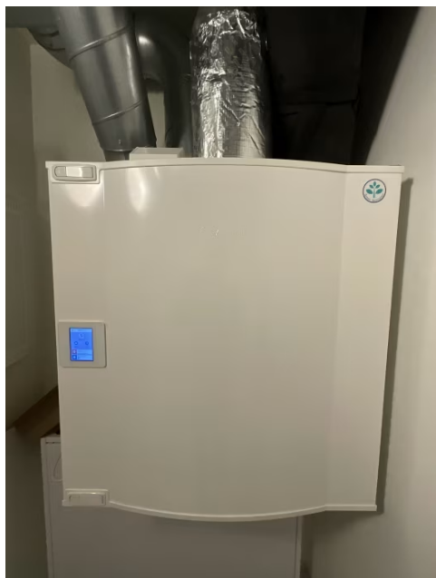
Viser ventilasjonsaggregat plassert i teknisk rom.
