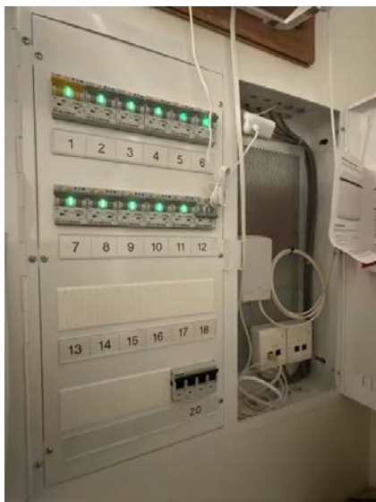
Viser sikringsskap med ekom del.
