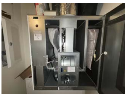
Viser ventilasjonsaggregat innvendig.
