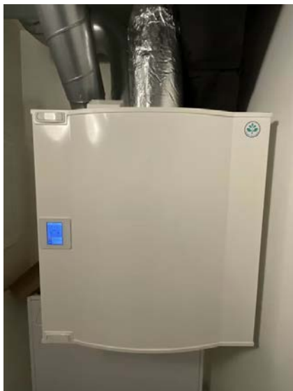
Viser ventilasjonsaggregat plassert i teknisk rom.
