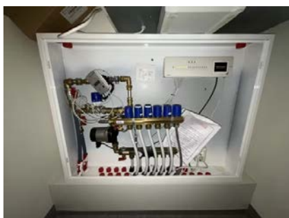
Viser gulvvarmeskap plassert i teknisk rom.
