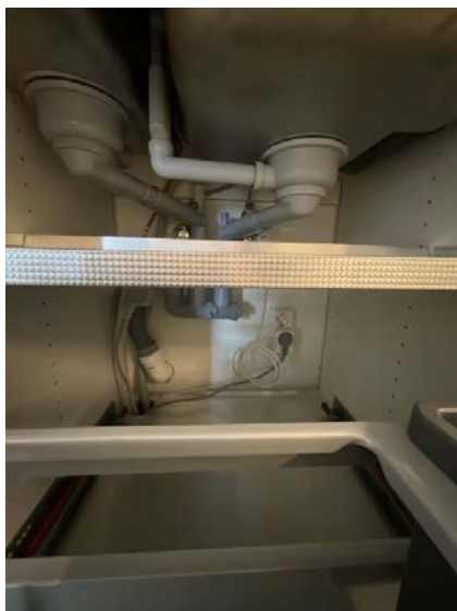
Viser vann og avløpsinnstallasjoner under kum.
