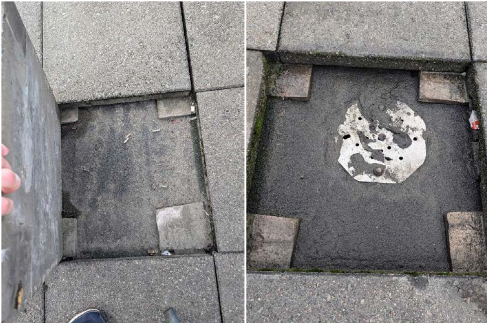
Bildene over viser membranen under hellene og sluk. Det ble observert søppel, sand under hellene.
