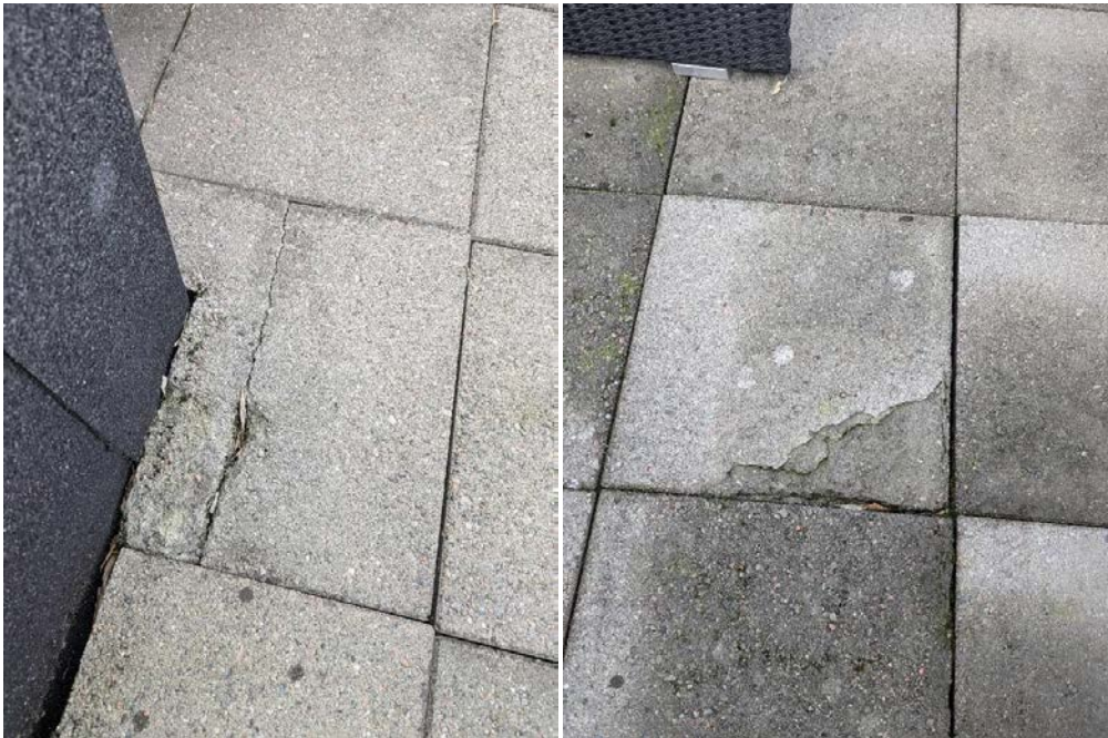
Bildene over viser sprukket og skadet heller.
