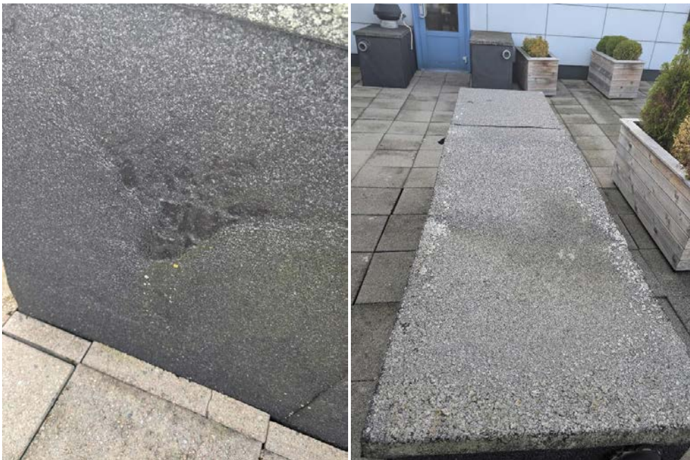
Bildene over viser luftekasse. Membranen har seget noe og toppen av kassa har mot fall så vann blir liggende oppå kassa.
