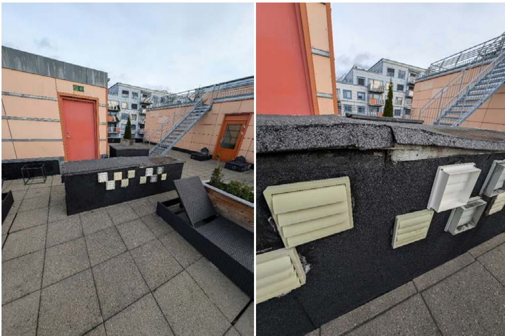
Bildene over viser lufttekasse hvor toppen er skadet.
