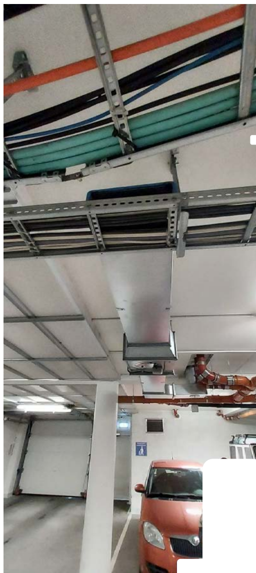
Avkastvarme fra leilighetene inn i garasjen.
