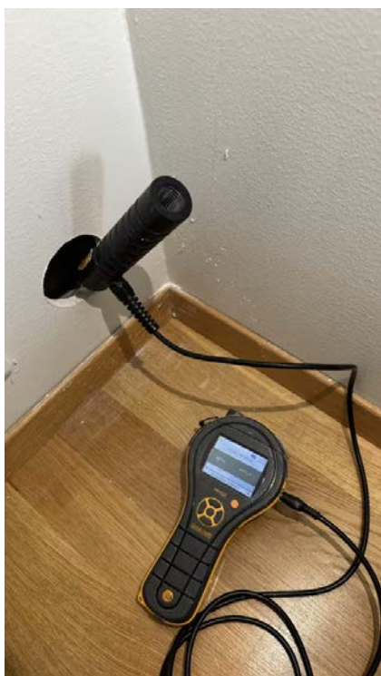
Hultaking er foretatt fra tilstøtende rom mot våtsone uten å påvise avvik.
