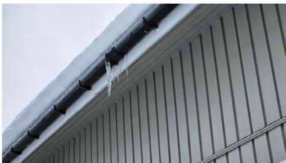
Isdannelse bak takrenne.
