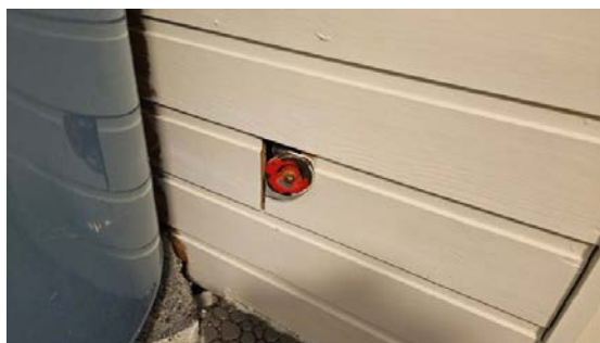
Kontroll av innvendig hovedstoppekrane.
