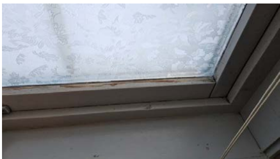
Malingsavflassing i vindu.
