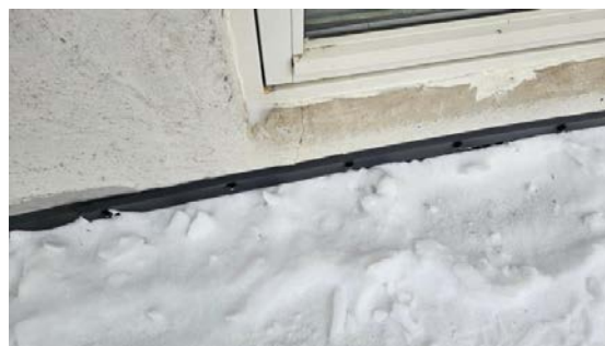
Riss i grunnmur.
