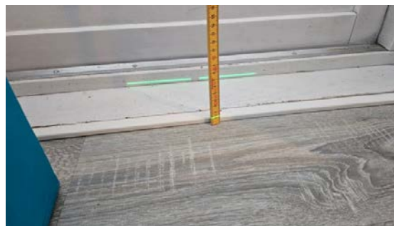
Kontroll av planavvik.
