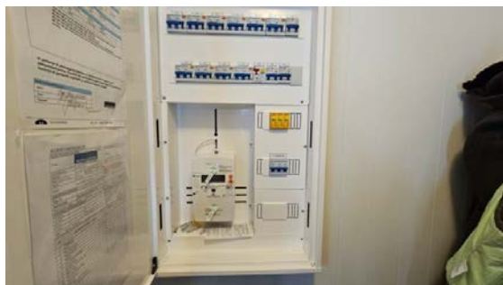
Kontroll av el-skapet.
