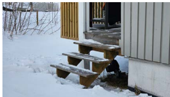
Manglende gelender langs trappeløpet.
