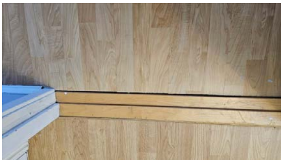
Manglende avslutning mellom laminat på gulv og dørterskel.
