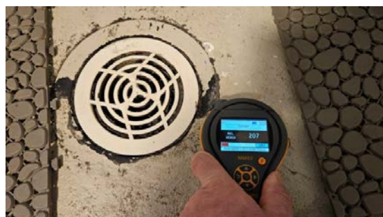
Fuktmåling i gulvet, noe forhøyede fuktverdier ble registrert.
