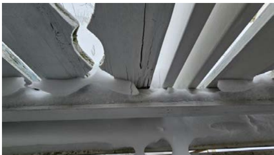
Svekkelser i rekkverket på balkongen.
