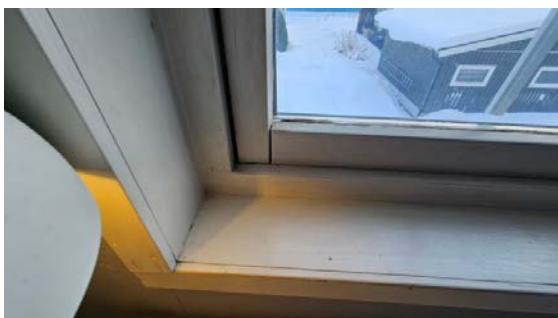
Enkelte vinduer har skjevheter mellom vindusramme og karm.
