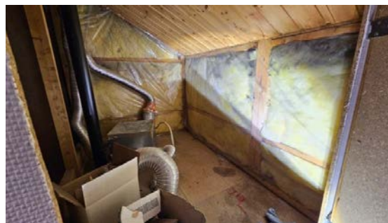
Synlig isolasjonen på knekottet er stedvis svart, dette tyder på uttettheter i dampsperran.
