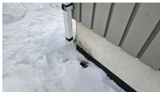
Taknedløp ikke tilkoblet drenering.
