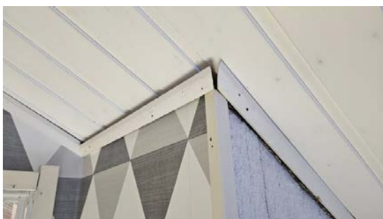
Stedvis ufagmessig montert listverk.
