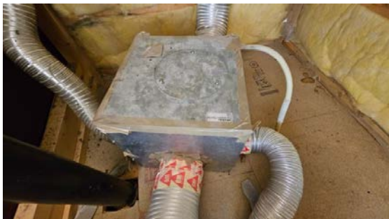
Avtrekksvifte på knekott.
