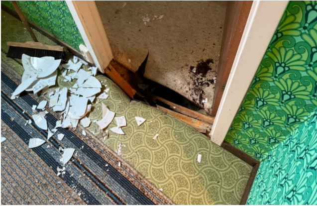
Råteskade i gulvet
