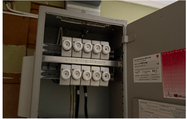
Sikringsskapet er plassert i gangen på loftet.
