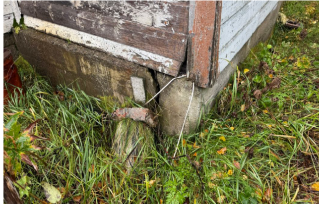
Sprekk i grunnmuren.
