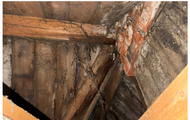
Skader i takkonstruksjonen på opprinnelig del.
