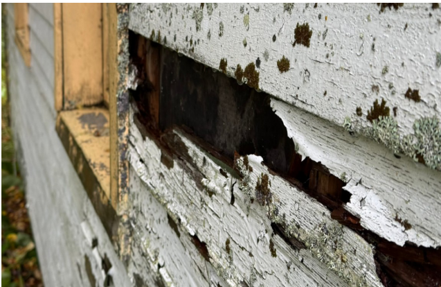
Eksempel på råteskadet kledning.
