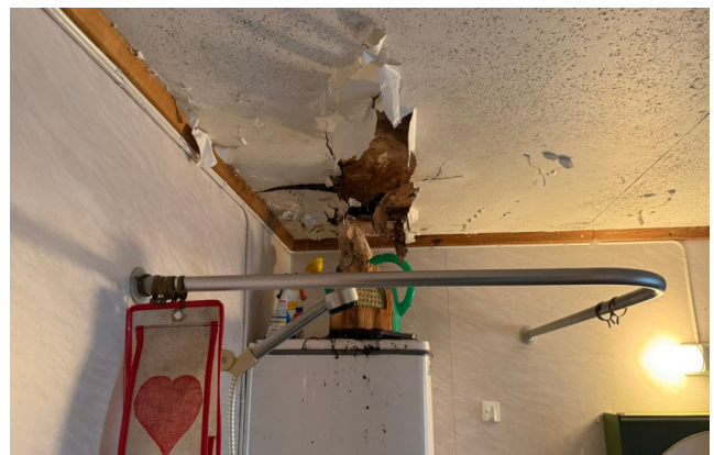
Skader på badet
