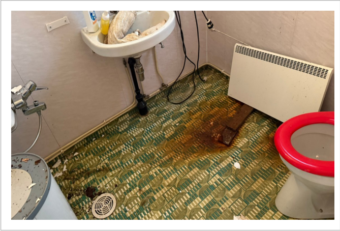
Skader på badet
