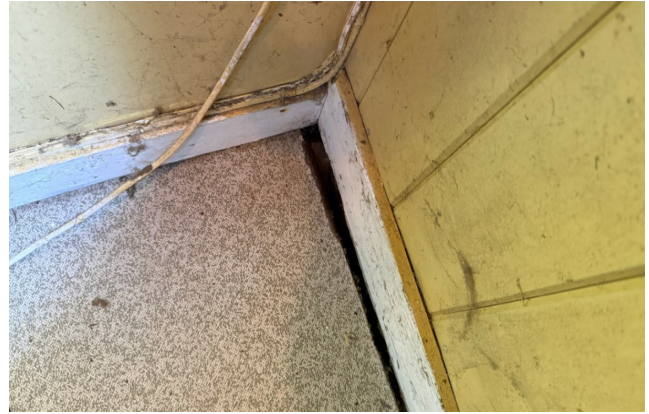
Råteskade i gulvet har ført til åpning mellom gulv og vegg
