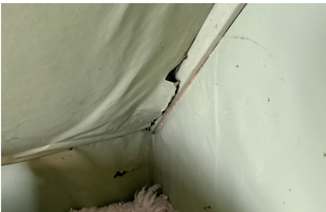
Skader i himlingen på loftet som følge av utett takteking.
