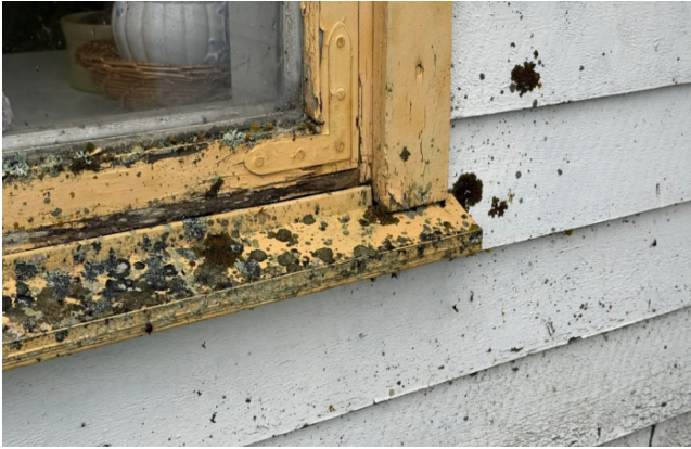
Eksempel på skade på vindu
