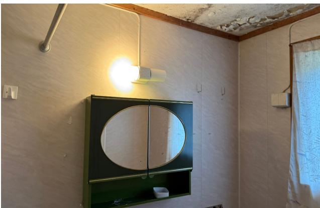
Skader på badet
