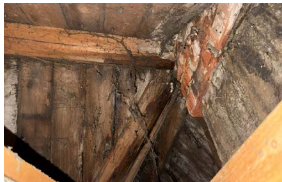
Skader i takkonstruksjonen på opprinnelig del.
