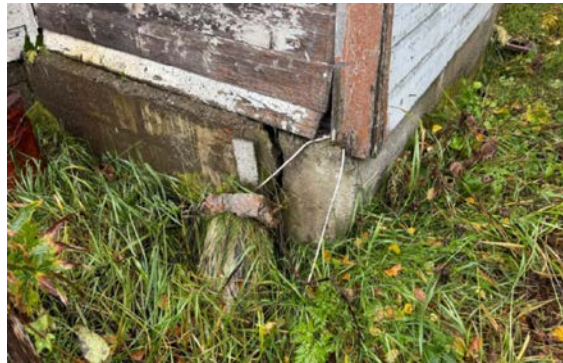
Sprekk i grunnmuren.
