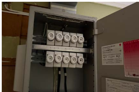
Sikringskapet er plassert i gangen på loftet.
