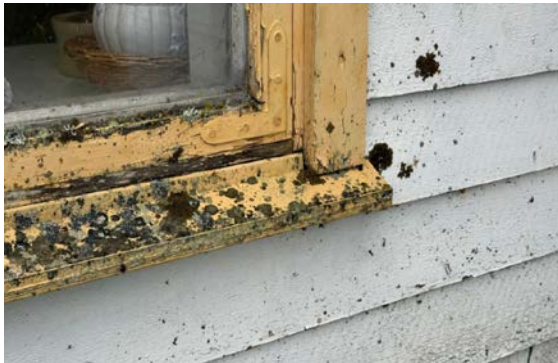
Eksempel på skade på vindu
