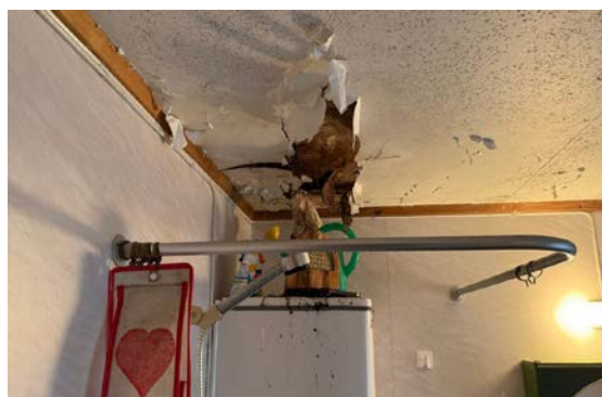
Skader på badet
