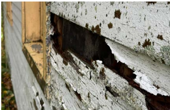
Eksempel på råteskadet kledning.
