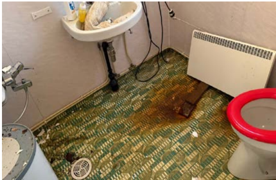
Skader på badet
