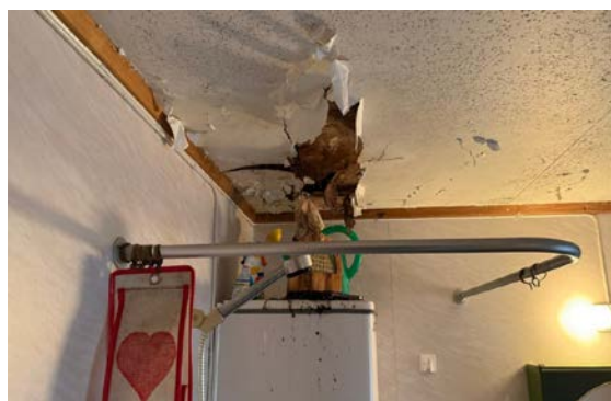
Skader på badet
