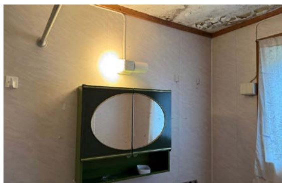
Skader på badet
