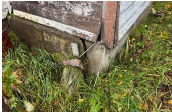
Sprekk i grunnmuren.
