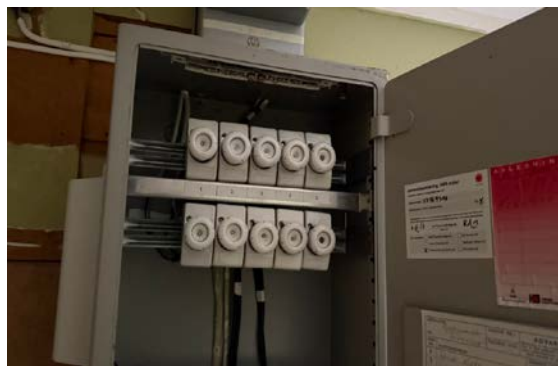
Sikringskapet er plassert i gangen på loftet.
