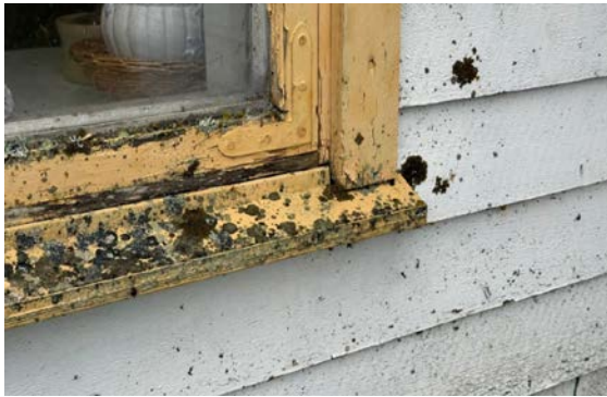
Eksempel på skade på vindu
