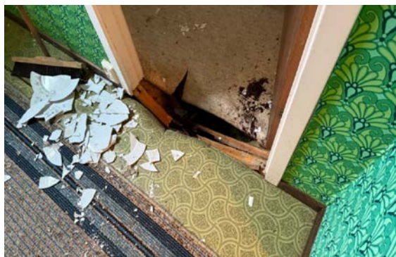
Råteskade i gulvet
