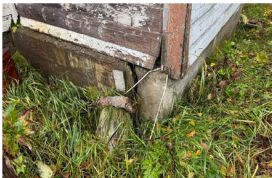
Sprekk i grunnmuren.
