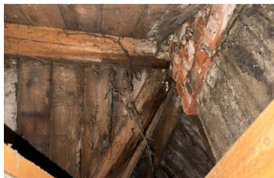
Skader i takkonstruksjonen på opprinnelig del.
