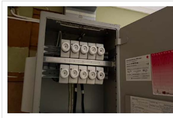
Sikringskapet er plassert i gangen på loftet.
