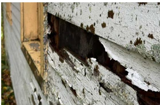
Eksempel på råteskadet kledning.
