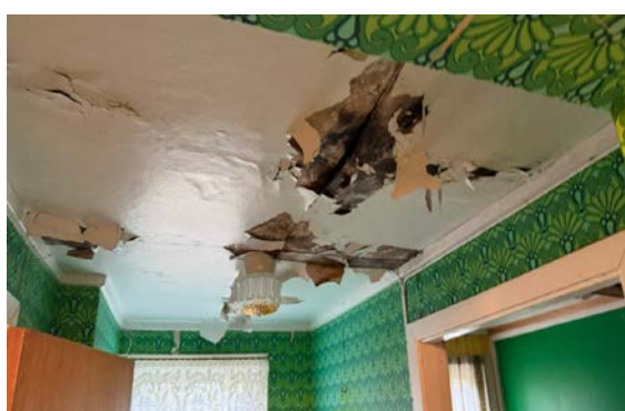
Vannskadet himling, det er ikke mulig å vurdere overliggende konstruksjon.
