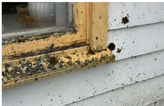
Eksempel på skade på vindu
