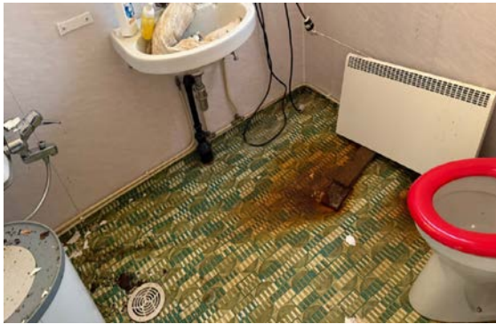
Skader på badet
