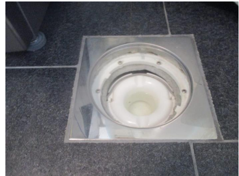
Sluk ved bereder.
