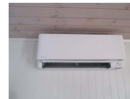
Varmepumpe i stue.
