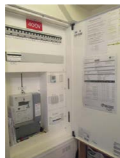
Sikringsskapet er plassert på kott under trapp.
