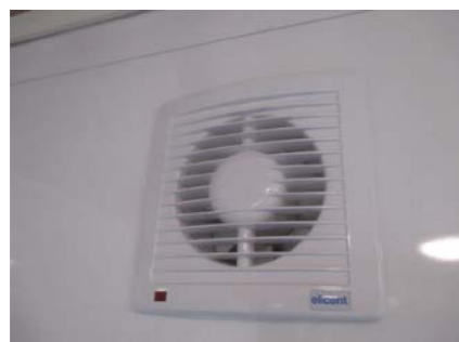
Vifte i ytterveggen.
