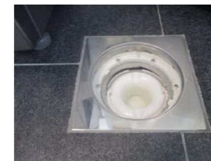
Sluk ved bereder.
