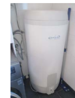
Bereder er plassert på bad/vaskerom.
