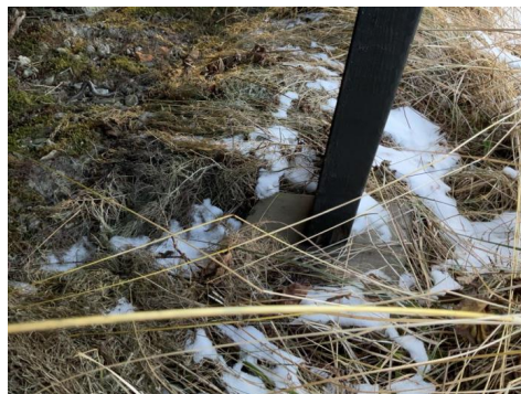
Enkel fundamentering er årsaksammenheng med skjevheter i konstruksjoner
