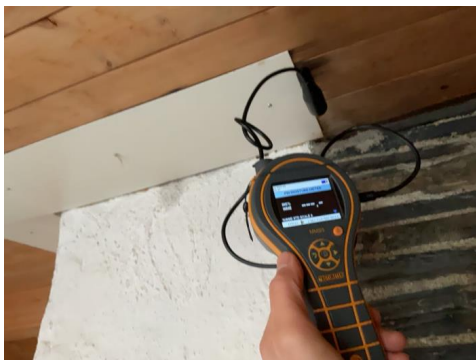
Fuktskjold ved pipestamme, ved fukt måletaking var det ikke fuktutslag
