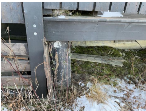
Skjevhet i pilar som ikke er sentrert med veggens børekonstruksjon
