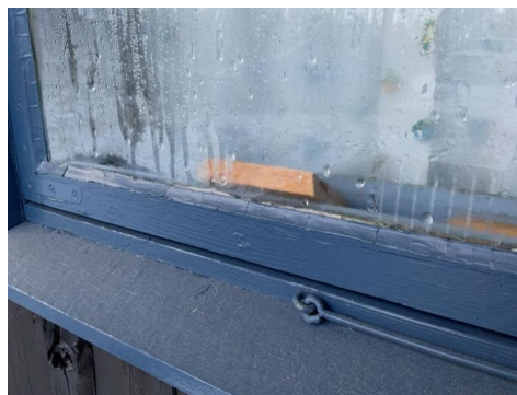
Kondensering og sprekkdannelse i kitt
