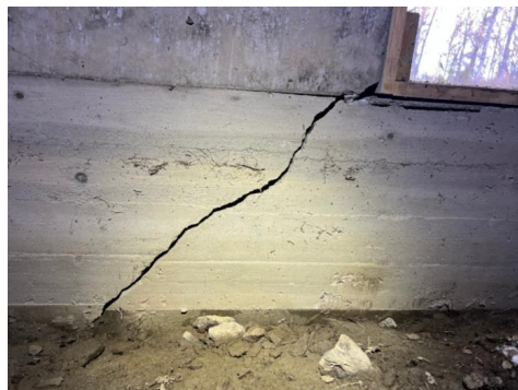
Sprekker i grunnmur
