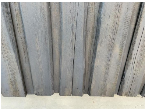
Sprekkdannelse og slitasje på kledning
