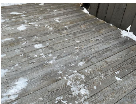
Vedlikeholdsbehov av terrassegolv ved inngang
