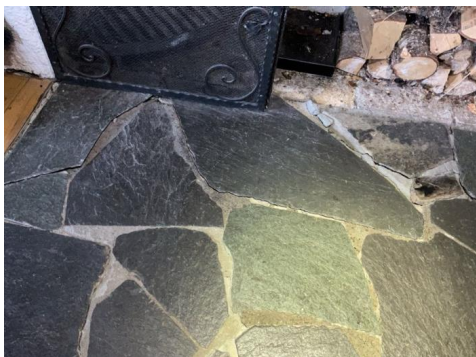
Bom (hullrom) og løs skifer på gulv
