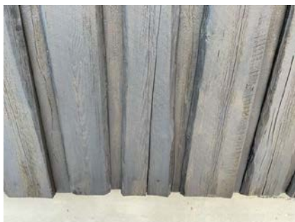
Sprekkdannelse og slitasje på kledning
