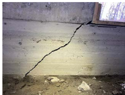
Sprekker i grunnmur
