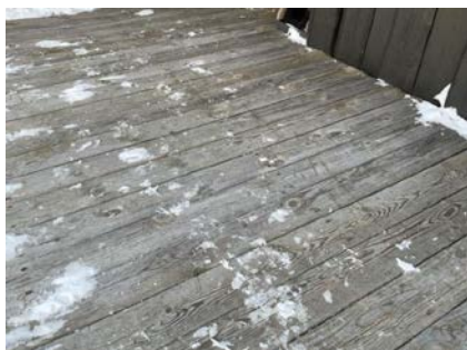
Vedlikeholdsbehov av terrassegulv ved inngang
