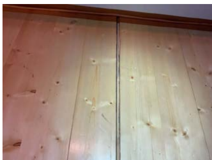
Glippe i skjøt fra bad, stedvis glipper i overganger og fare for inngangs fra mus/skadedyr.
