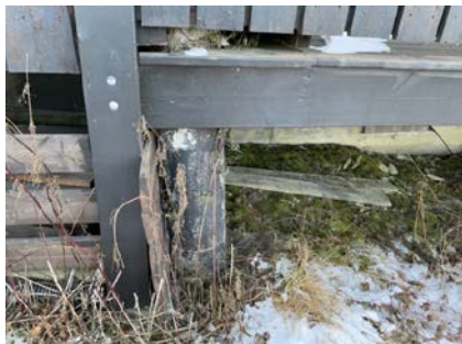
Skjevhet i piler som ikke er sentrert med veggens bærekonstruksjon
