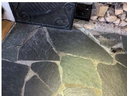
Bom (hullrom) og løs skifer på gulv
