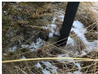
Enkel fundamentering er årsaksammenheng med skjevheter i konstruksjoner
