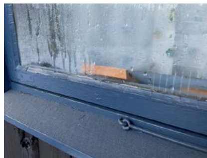
Kondensering og sprekkdannelse i kitt
