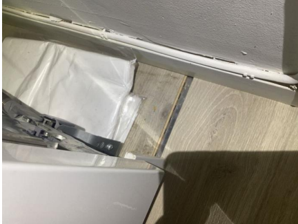
Glippe i laminatskjøt ved oppvaskmaskin.
