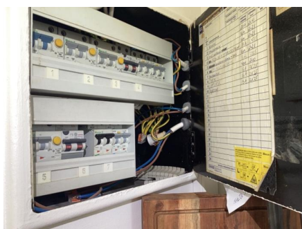
Sikringsskap lokalisert på kjøkken.
