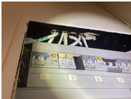
Utette kabelføringer i sikringsskap.
