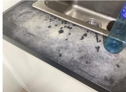
Misfarging på benkeplate.
