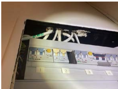
Utette kabelføringer i sikringsskap.
