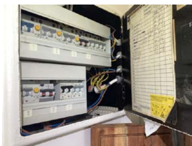
Sikringsskap lokalisert på kjøkkenet.
