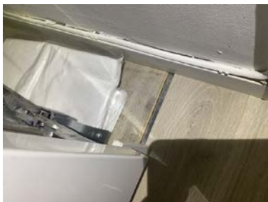
Glippe i laminatskjøt ved oppvaskmaskin.
