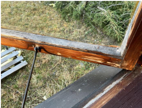
Slitasje på vindu
