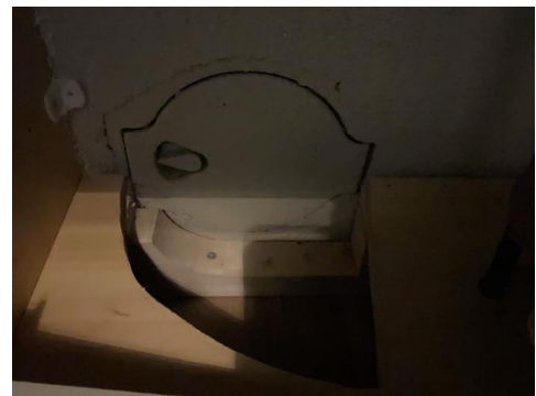
Sotluke er plassert i skap på kjøkken
