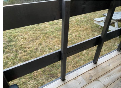
Åpning i rekkverk
