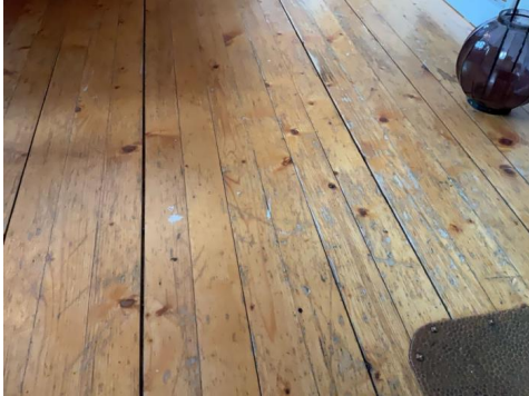
Gulvslitasje der slip/overflatebehandling må påregnes
