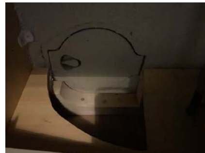
Sotluke er plassert i skap på kjøkken
