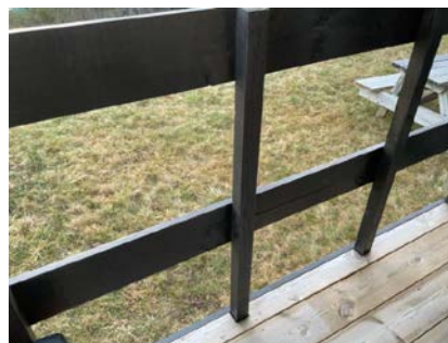
Åpning i rekkverk
