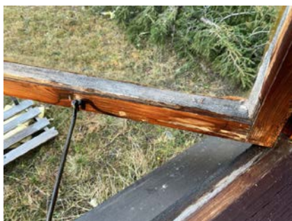
Slitasje på vindu
