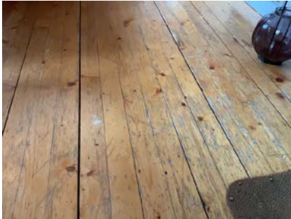
Gulvslitasje der slip/overflatebehandling må påregnes
