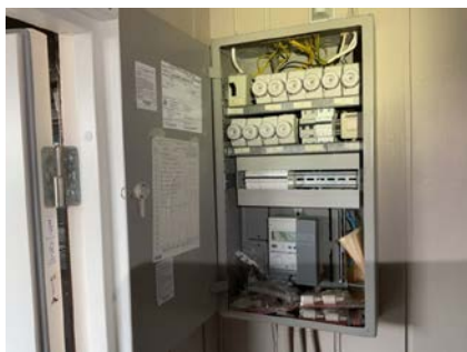
Sikringskap i vindfang.
