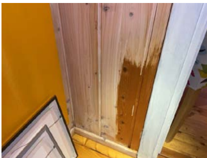
Gjenstår tiltak på enkelte overflater der oppussing bør foretas, da det er stedvis påbegynt og med ufagmessighet
