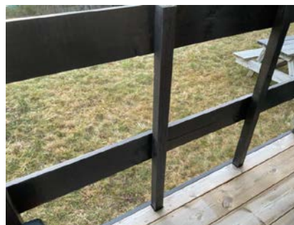
Åpning i rekkverk
