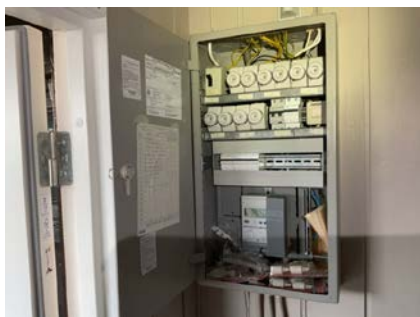
Sikringskap i vindfang.
