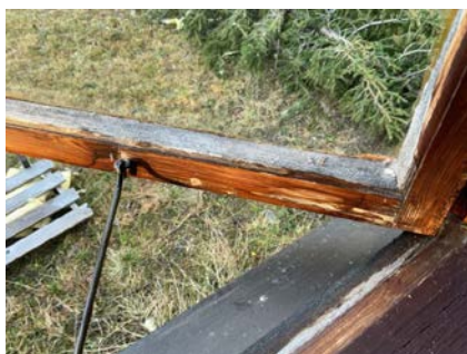
Slitasje på vindu
