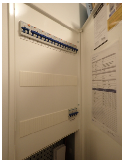
Sikringsskap med automatsikringer.
