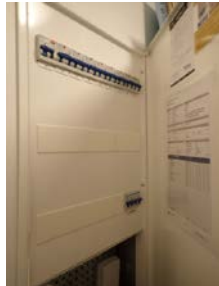
Sikringsskap med automatsikringer.
