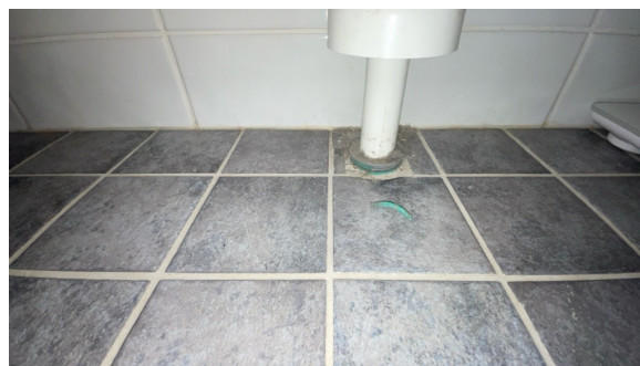
Manglende membranoppkant rundt rørgjennomføringer.
