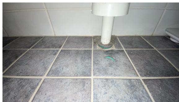
Manglende membranoppkant rundt rørgjennomføringer.
