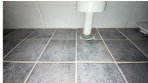
Manglende membranoppkant rundt rørgjennomføringer.
