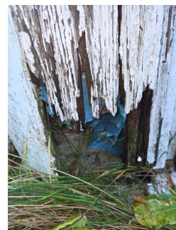
Råte på hjørne og det er synlig plast i veggen utvendig. Feil utførelse
