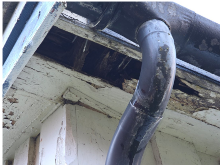
Råte i takkonstruksjon tilbygg
