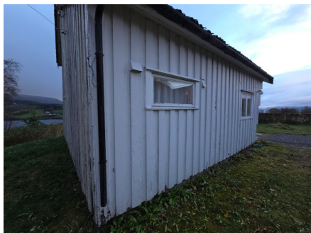
Takvannet er ført ned mot terreng. Her er avløp avsluttet oppe på veggen og det er fare for skjulte skader i veggen grunnet fukt
