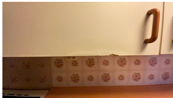
Fuktskade på ei dør til overskap
