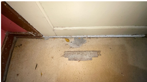
Sprekk/skade i belegg ved inngangsdør i gang
