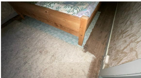
Mangler belegg på deler av soverom 2
