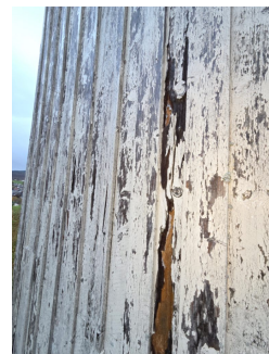
Synlig råte i kledning på gavelvegg i kledning montert utenpå den gamle kledningen. Tilstand på bakenforliggende kledning er ukjent
