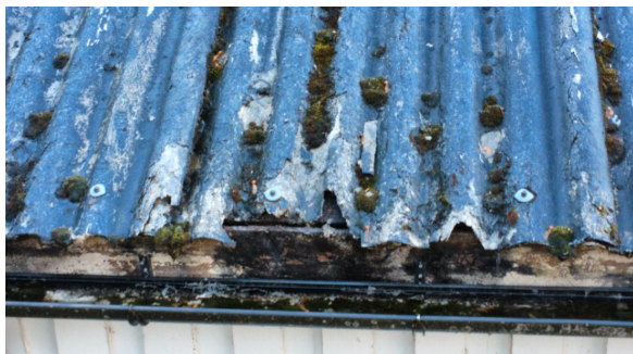
Skade i nedre del av takteking over tilbygg med synlig innvendig skade
