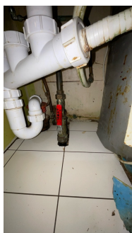
Hovedstopekrane er plassert i kjøkkenskap
