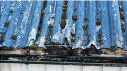
Skade i nedre del av takteking over tilbygg med synlig innvendig skade
