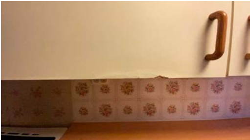
Fuktskade på ei dør til overskap
