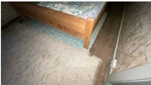
Mangler belegg på deler av soverom 2
