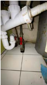
Hovedstopekrane er plassert i kjøkkenskap
