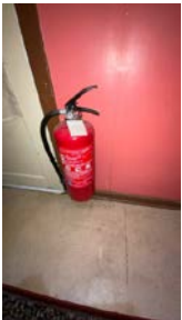
Brannslukker i 1. etasjen fra 2009
