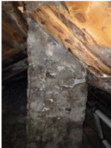
Sprekker i pipeløp og saltutslag i pipe sett fra kryploft
