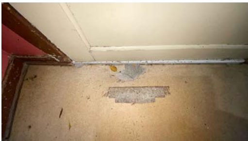
Sprekk/skade i belegg ved inngangsdør i gang
