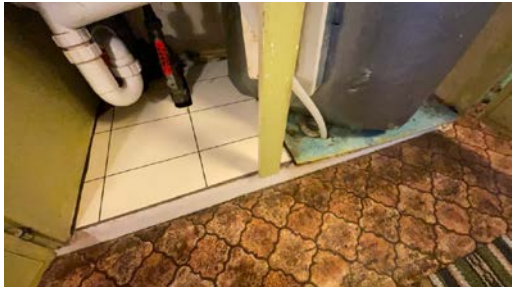
Plate i bunn av skap under vask er vannskadet. Bytte må påregnes.
