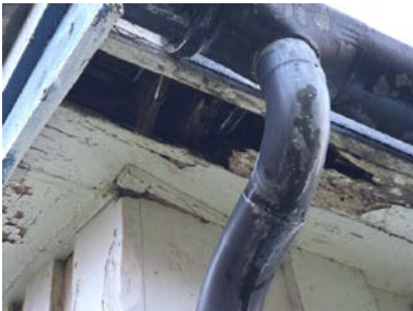
Råte i takkonstruksjon tilbygg
