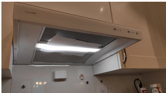
Funksjonstest av avtrekk.
