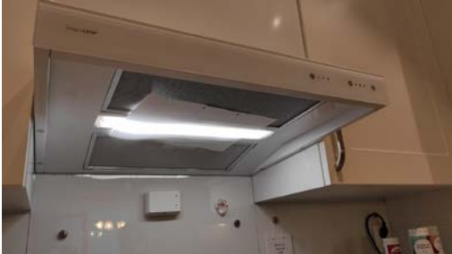
Funksjonstest av avtrekk.
