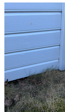
Kledning nær bakken på plenen.
