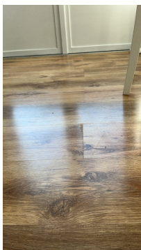
Svellet skjøter på laminatgulv i stue.
