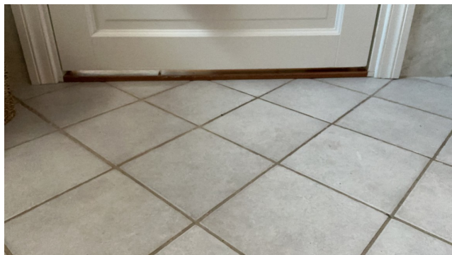
Spalte under dør for tilluft.
