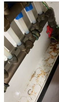
Rustflekker i bunnen av skapet. Og stoppekran i skapet.
