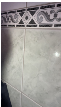
Riss i flis på yttervegg under vindu.
