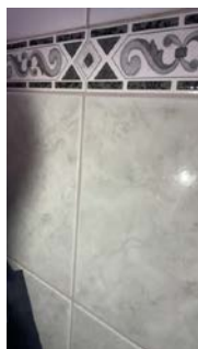
Riss i flis på yttervegg under vindu.
