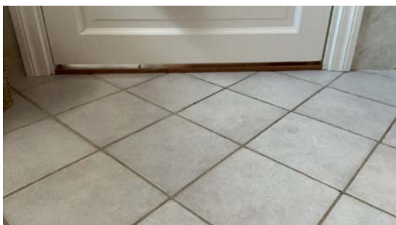
Spalte under dør for tilluft.
