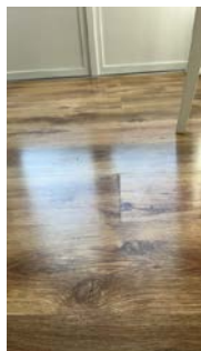
Svellet skjøter på laminatgulv i stue.
