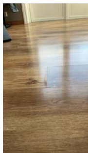
Svellet skjøter på laminatgulv i stue.
