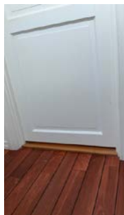
Luftespalte under dør for tilluft.
