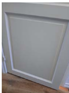
Bilde tilsendt fra huseier etter maling.
