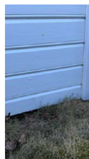
Kledning nær bakken på plenen.
