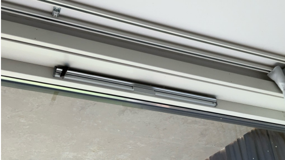
Eksempel på montert ventil i vindu.
