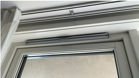
Eksempel på montert ventil i vindu.
