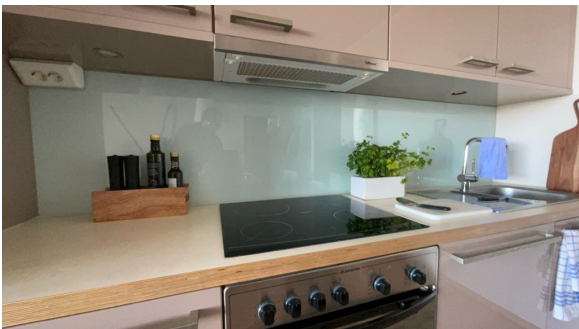
Montert avtrekk over steketopp.
