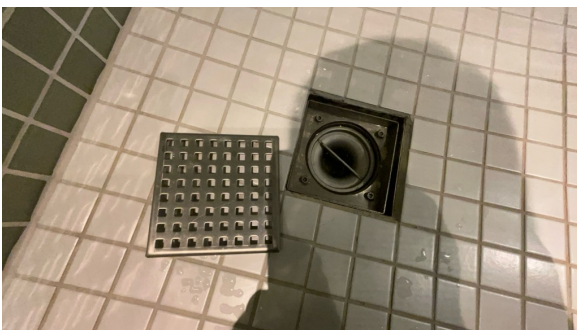
Sluk i gulv.
