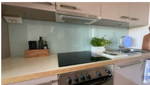
Montert avtrekk over steketopp.
