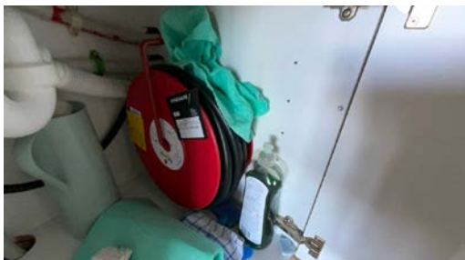
Husbrannslange med vann.
