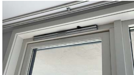
Eksempel på montert ventil i vindu.
