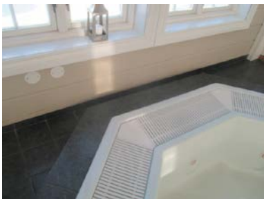
Vinduer og panel nær nedfelt badekar.
