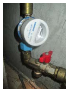
Innvendig stoppekran med vannmåler er plassert på vaskerommet
