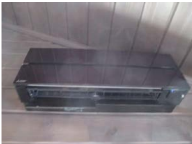
Varmepumpe i stue.
