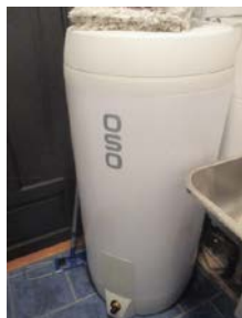
Bereder er plassert på vaskerommet
