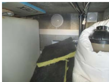
Teknisk anlegg for boblebad i enden av carport.
