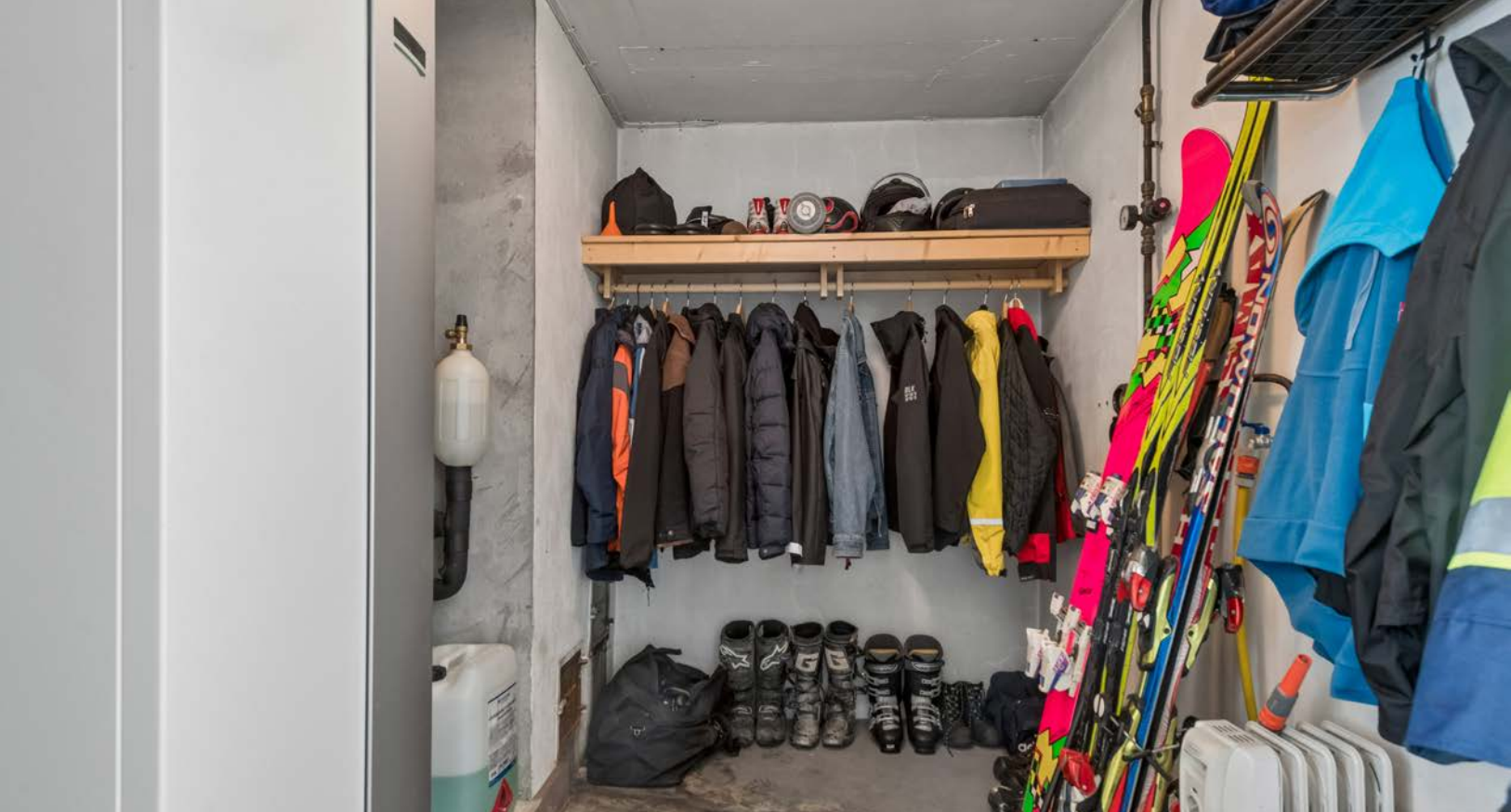
Teknisk rom med frekvensstyrt bergvarmepumpe m/varmtvannsbereder.
