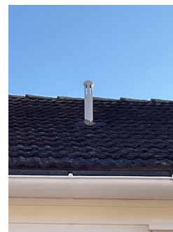
Ikke tilfredstillende tette rundt luftelyre.
