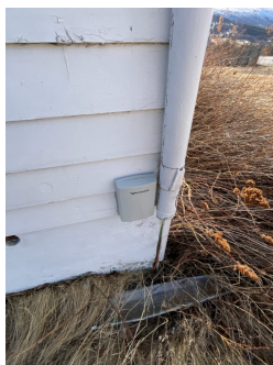
Takvann er ikke ledet bort fra grunnmuren.
