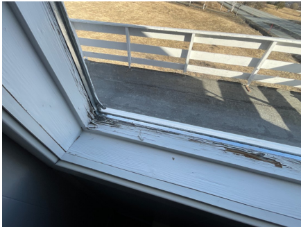
Vindu med tegn til råte
