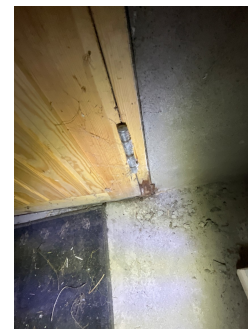
Tegn til fuktopptrekk i kjellerdøren
