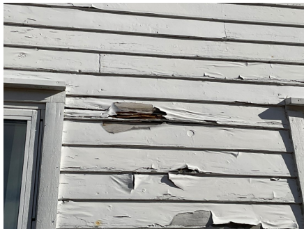
Råteskader i panelet
