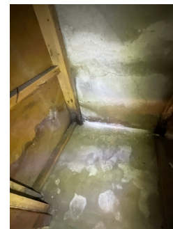
Råteskader i understøttelsen for trappen.
