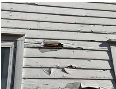
Råteskader i panelet
