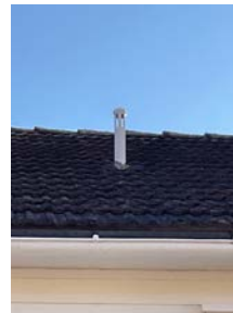
Ikke tilfredstillende tette rundt luftelyre.
