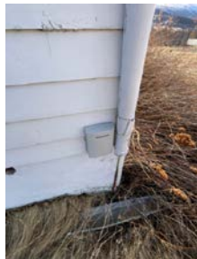
Takvann er ikke ledet bort fra grunnmuren.
