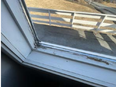
Vindu med tegn til råte
