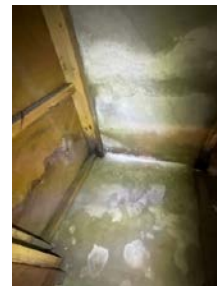
Råteskader i understøttelsen for trappen.
