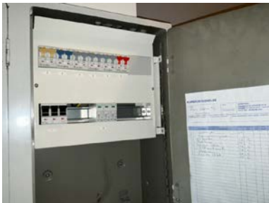
Automatsikringer i sikringsskap plassert i gang/fellesareal.
