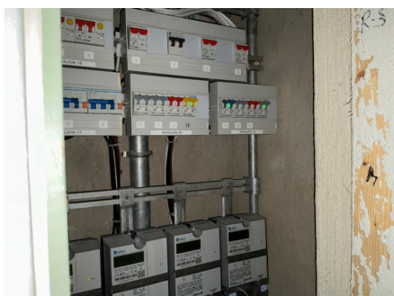
Automatsikringer i felles tavlerom plassert i gang/fellesareal.
