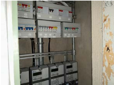
Automatsikringer i felles tavlerom plassert i gang/fellesareal.
