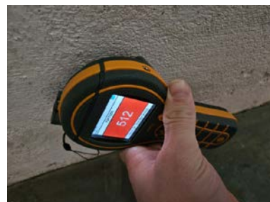
Fukstøk på vegg under terreng mot gulv.
