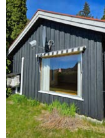
Fasade mot syd og vest har høy slitasjegrad.
