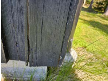
Eksempel på skadet kledningsbord
