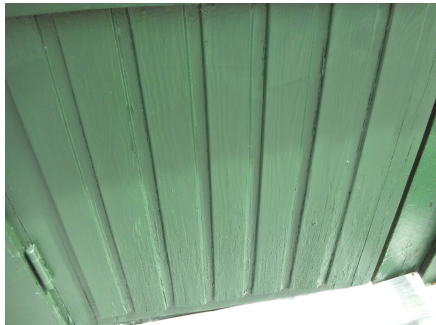
Noe slitasje på utvendig brystning
