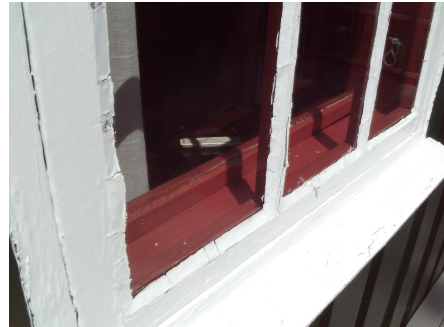
En del utvendig slitasje.
