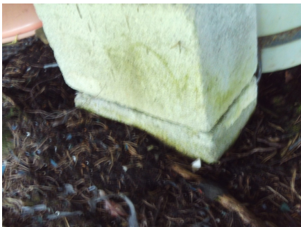
Ligger jordmasser i rundt pilarer
