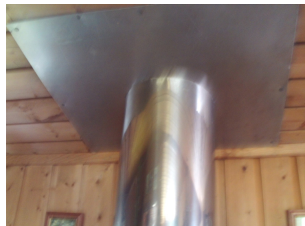
Pipe av uisolert stålrør.
