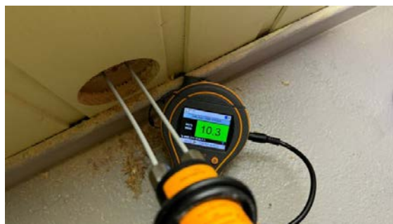
Bilde viser hulltaking i tilstøtende vegg mot våtsone.
