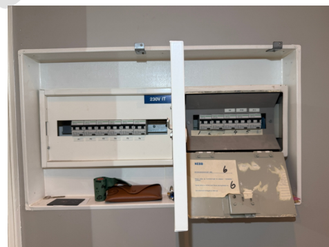
Elskap, plassert i entre.
