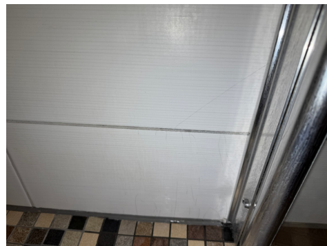
Sprekker og krakkelering i nedkant av fliser i dusjsone.
