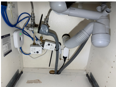
Rørpropp i kjøkkenbenk
