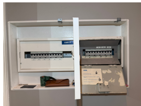
Elskap, plassert i entre.
